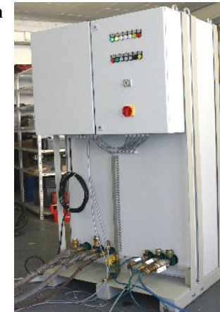
E-Schrankseite/Außenansicht Gaseversorgungsanschlüsse Erdgas G 1 1/4" Sauerstoff G 1" Luft G 1/2" mit kompletter Überwachung.
